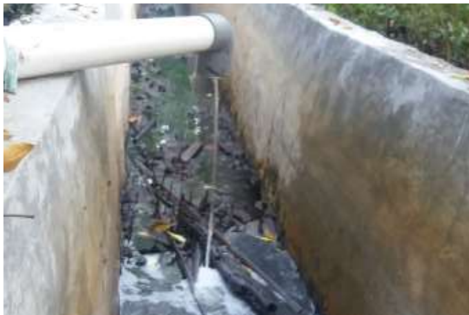
Gambar 4.8 Outlet IPAL Berbas Pantai
