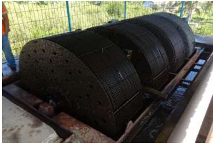
Gambar 4.17. RBC IPAL Loktuan
