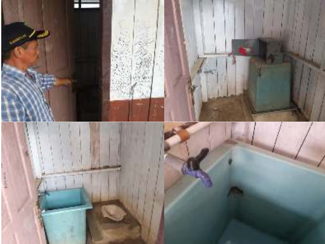
Gambar 4.263. Jamban di SDN 005 Lutan
