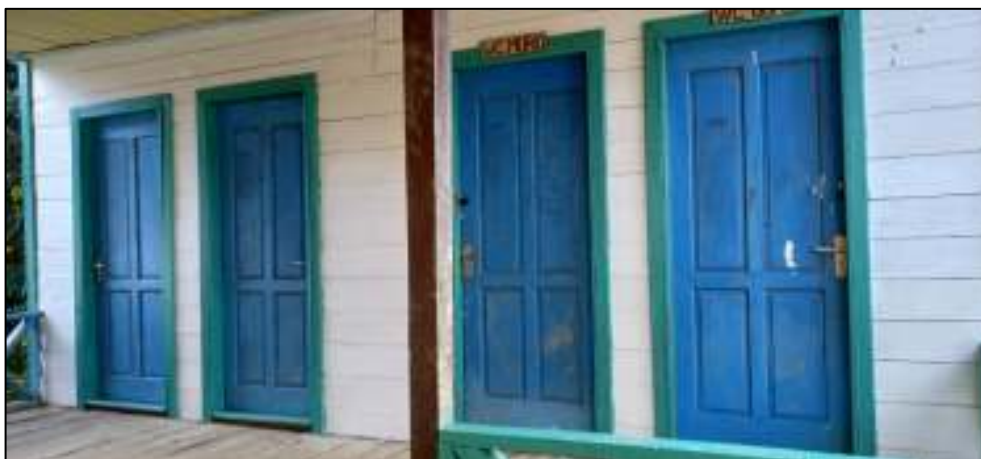
Gambar 4.83. Water Closet SD Negeri 008 Datang Maring
