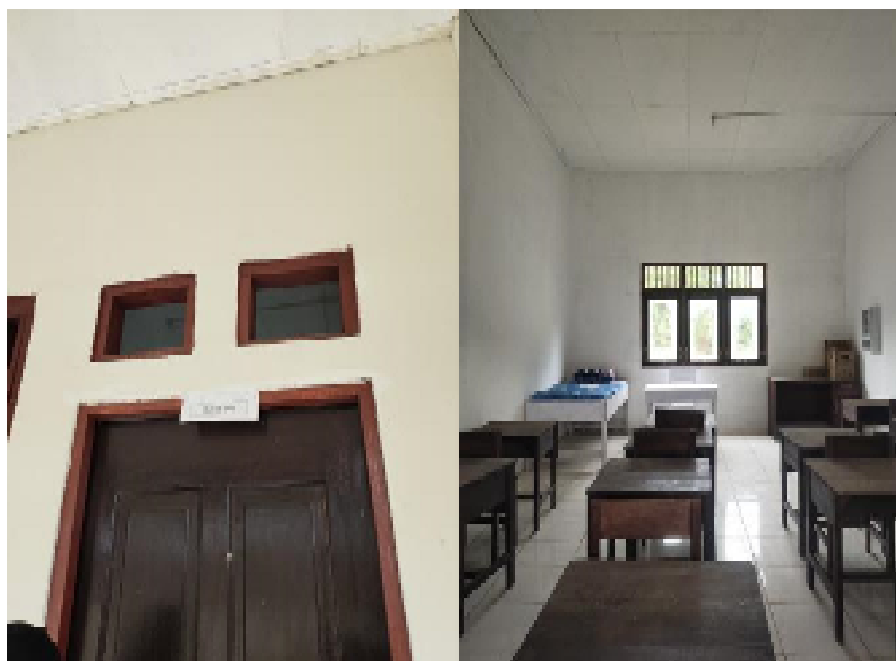
Gambar 4.135. Ruang UKS di SDN 005 Batu Majang
