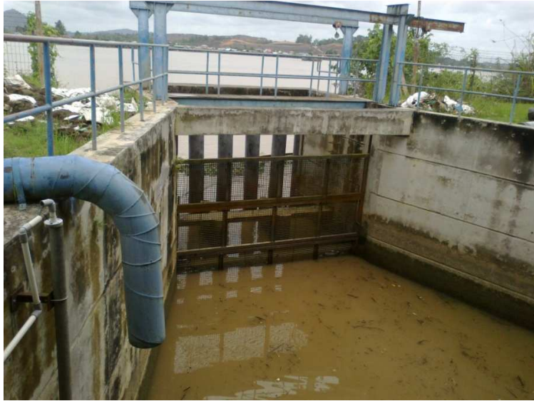
Lampiran 7.3 Intake Air Baku IPA Bendang di Loa Kulu
