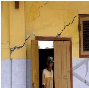
Gambar 9.4. Kerusakan atau Retak pada Dinding
