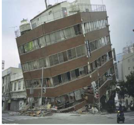
Gambar 9.5. Walaupun dalam Bencana Gempa Bangunan Tersebut Tidak Rubuh, Tetapi Mengalami Kerusakan Berat, Sehingga Strukturnya Mengalami Deformasi dan Tidak Layak.
