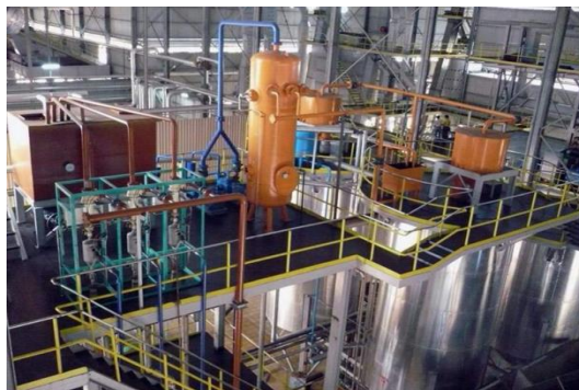
Gambar 6.11 : Stasiun Klarifikasi (Sumber : Teknologi Agroindustri Kelapa Sawit/Agung Nugroho)
