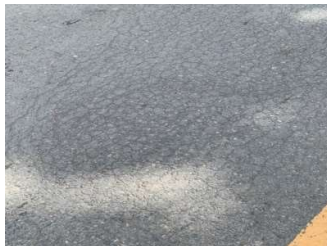
Gambar 8 Kerusakan Retak Buaya
