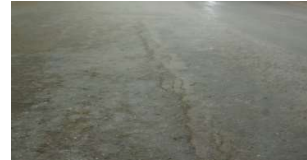
Gambar 12 Kerusakan Retak Memanjang
