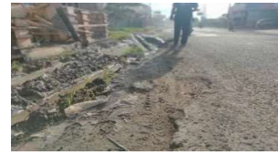
Gambar 11 Kerusakan Retak Pinggir
