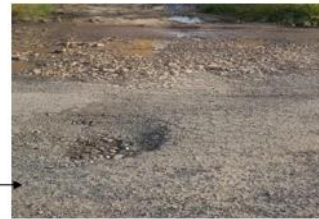
Kondisi jalan yang berlubang di dekat simpangan
