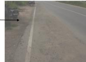
Kondisi jalan yang berpasir, membuat jalan menjadi licin dan berdebu
