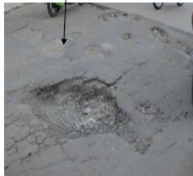
Kondisi jalan yang berlubang
