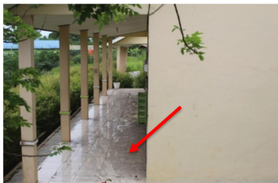
Gambar 3. Kondisi depan kelas yang berdebu, akibat debu dari tambang batu bara.
