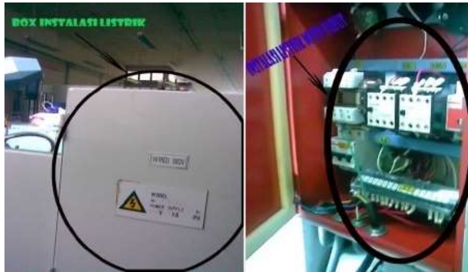
Box Pelindung Instalasi Listrik
