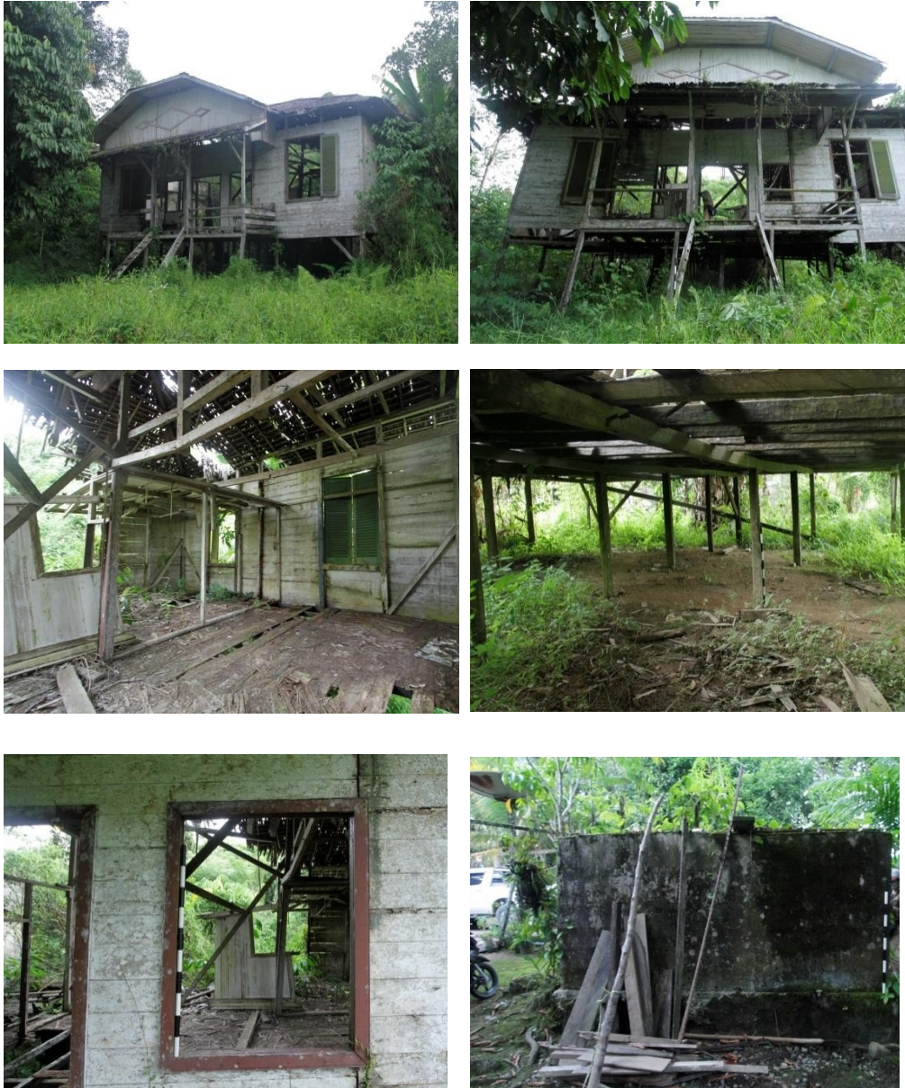
Foto 16. Kondisi Gereja Santo Antonius mengalami kerusakan yang cukup parah pada bagian atap, dinding, jendela, pintu, dan lantai, namun tiang-tiang ulin penyangga bangunan masih cukup baik. Di samping kiri dan belakang bangunan juga ditemukan bak penampung
