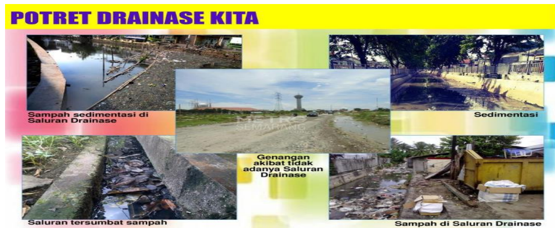
Gambar 3.16. Kondisi Drainase yang Ada (Gambar Merupakan Substitusi dari Kondisi yang ada)
