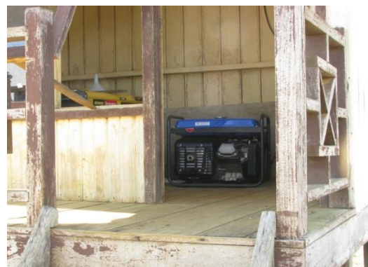
Alternatif Sarana Penyedia Listrik Dengan Menggunakan Genset
