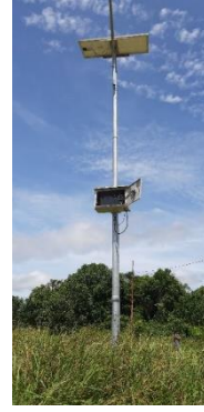
Penggunaan Lampu Tenaga Surya dengan memanfaatkan tenaga matahari di Desa Menjelutung
