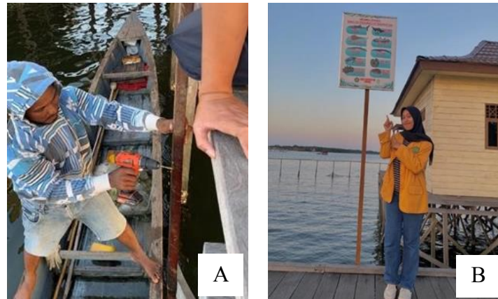
Gambar 2 Proses pemasangan papan informasi (A) dan Papan informasi yang telah terpasang (B)
