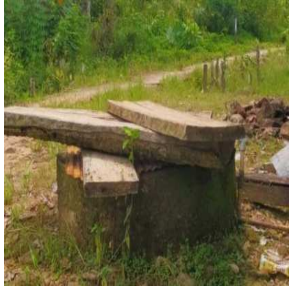
Sumur warga yang hanya ditutup dengan kayu
