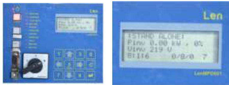
Gambar 3. Panel monitoring dan kontrol utama
