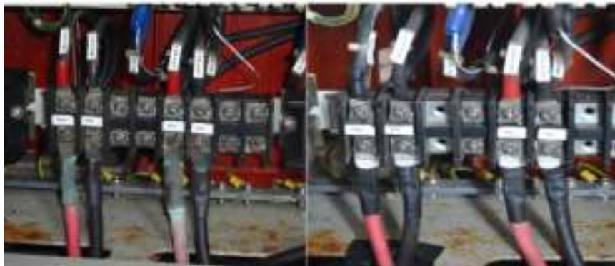
Gambar 2. Perbandingan kabel skun yang rusak dengan kabel skun yang baru
