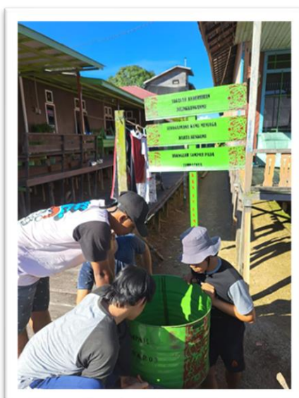
Gambar 2. Pemasangan Tempat Sampah dan Papan Ajakan di Setiap RT
