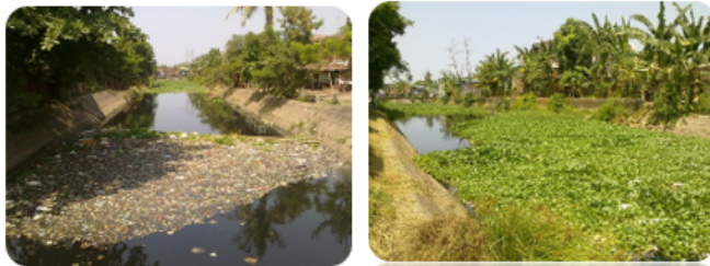
Gambar 9.1: Salah Satu Permasalahan Drainase Perkotaan
