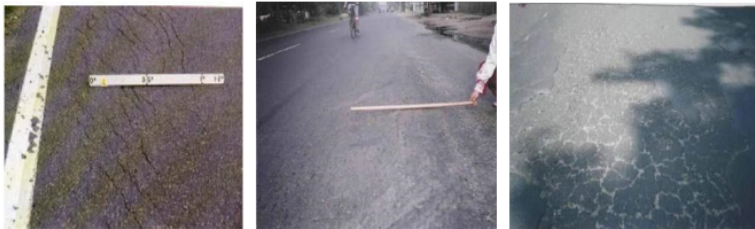
Gambar 9.7: Patah slip, megembang jembul dan pelepasan butir Bina Marga no.03/MN/B/1983
