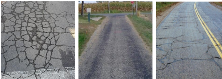
Gambar 9.2: Retak Kulit Buaya, Kegemukan dan Retak Kotak-Kotak
