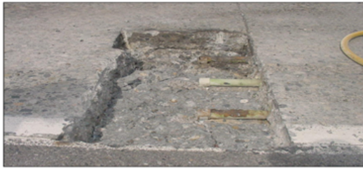
Gambar 12.4: Dowel rusak berat (Pemeliharaan Jalan, 2017)
