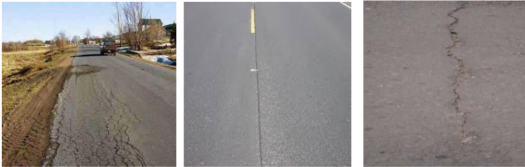
Gambar 9.4: Retak pinggir, retak sambungan dan pinggiran jalan turun vertikal. Bina Marga no.03/MN/B/1983
