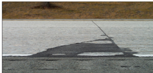
Gambar 12.5: Kerusakan tambalan (Pemeliharaan Jalan, 2017)
