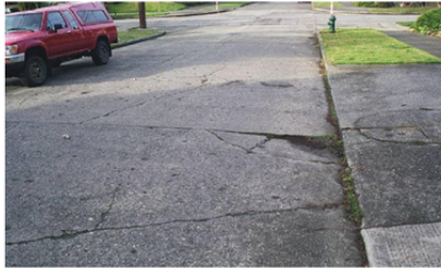
Gambar 12.2: Rusak sudut Jalan Permukiman (Pemeliharaan Jalan, 2017) Faulting (Pelat berseblahan tidak sama tinggi)
