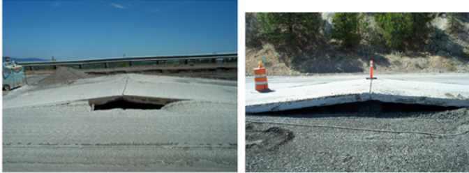
Gambar 12.1: Jenis kerusakan blow up (buckling) (Pemeliharaan Jalan, 2017) Rusak Sudut (Corner Break)
