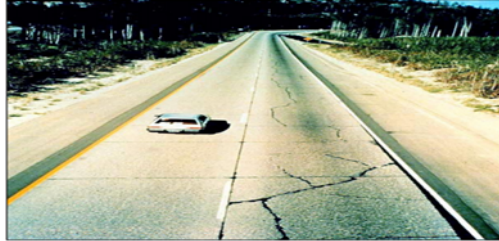
Gambar 12.6: Retak pelat pada lajur yang sering dilalui truk (Pemeliharaan Jalan, 2017)
