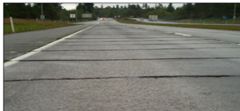
Gambar 12.3: Faulting (Pemeliharaan Jalan, 2017)
